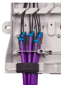
Ukončení mikrotubiček uvnitř rozvaděče
