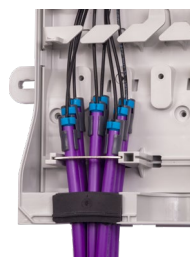
Ukončení mikrotrubiček uvnitř rozdávěče
