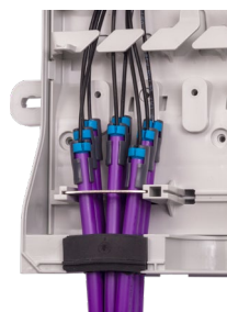
Ukončení mikrotrubiček uvnitř rozdávěče
