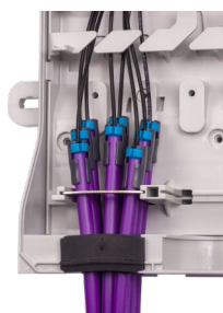
Ukončení mikrotrubiček uvnitř rozvaděče
